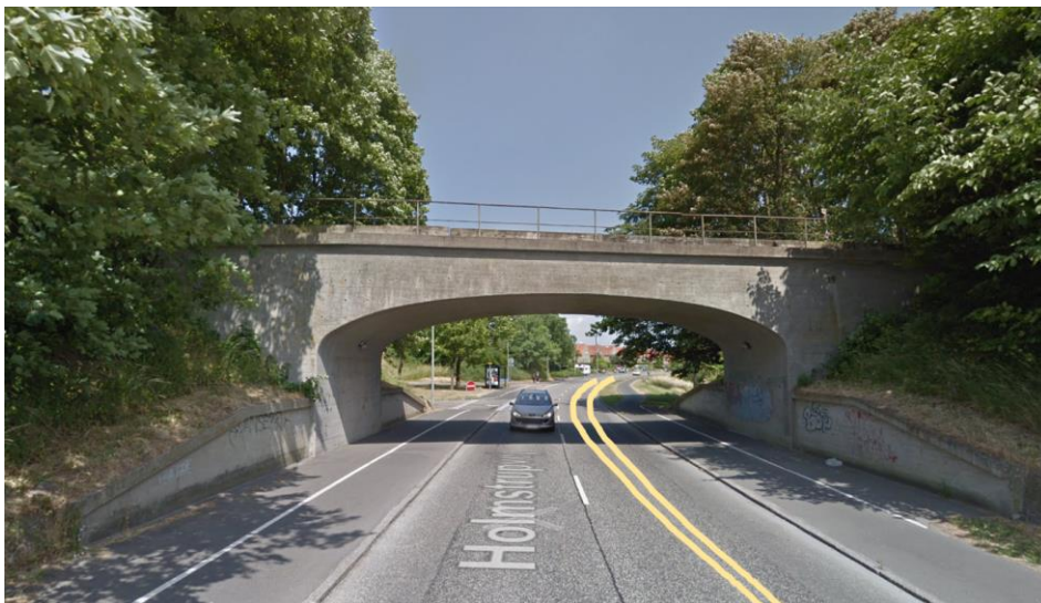
Figur 2.1: Foto af bro set fra syd mod nord. I østlig del af broen ses placering af nyt ledningsanlæg, som anlægges ved frigravning (lysegul markering).
